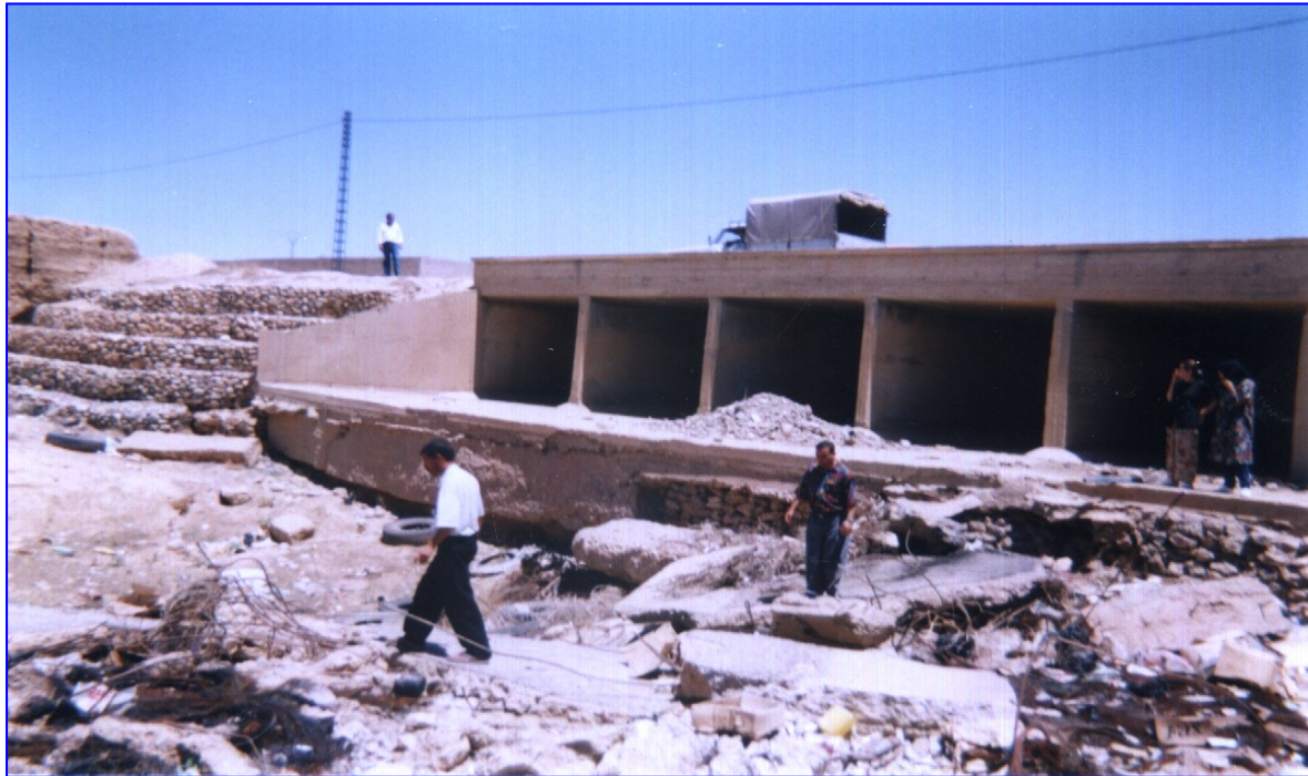
Photo 7 : Pont route oued Amar RN28 (érosion de 2m)
