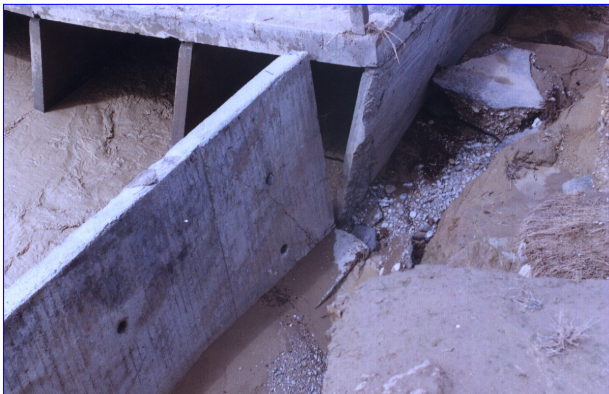
Photo 2: L'ouvrage après le passage de la crue de l'année 1998.
