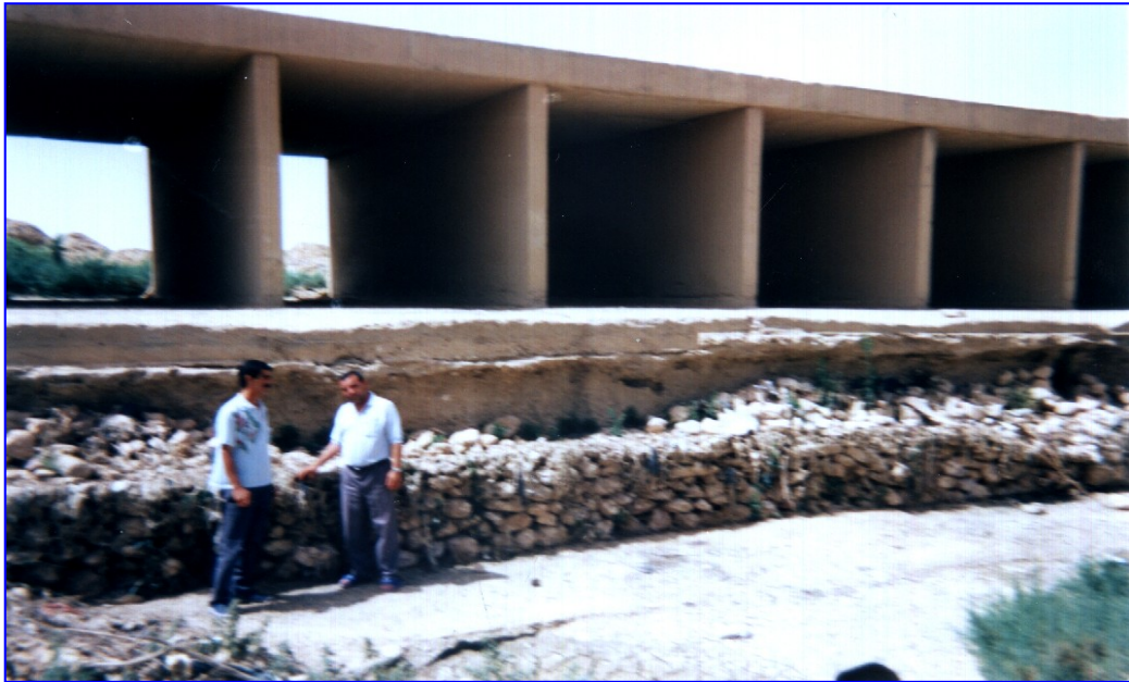
Photo 5: Le soulèvement du radier à l'aval de l'ouvrage
