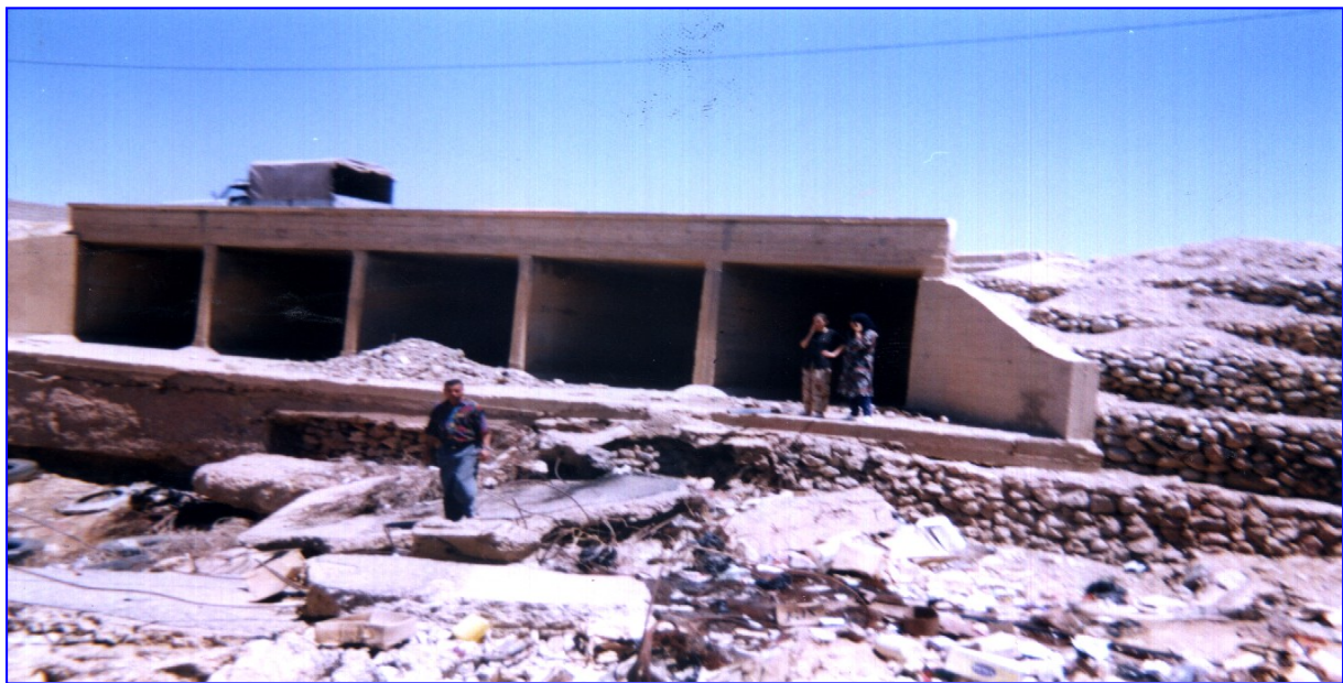
Photo 8 : L'érosion à l'aval de l'ouvrage ( Q=580\text{m}^3/\text{s} )
