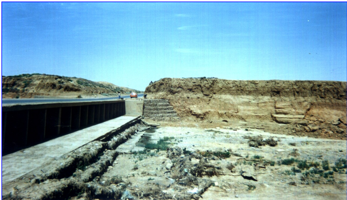
Photo 6: Vue longitudinale du pont après le passage de la crue
