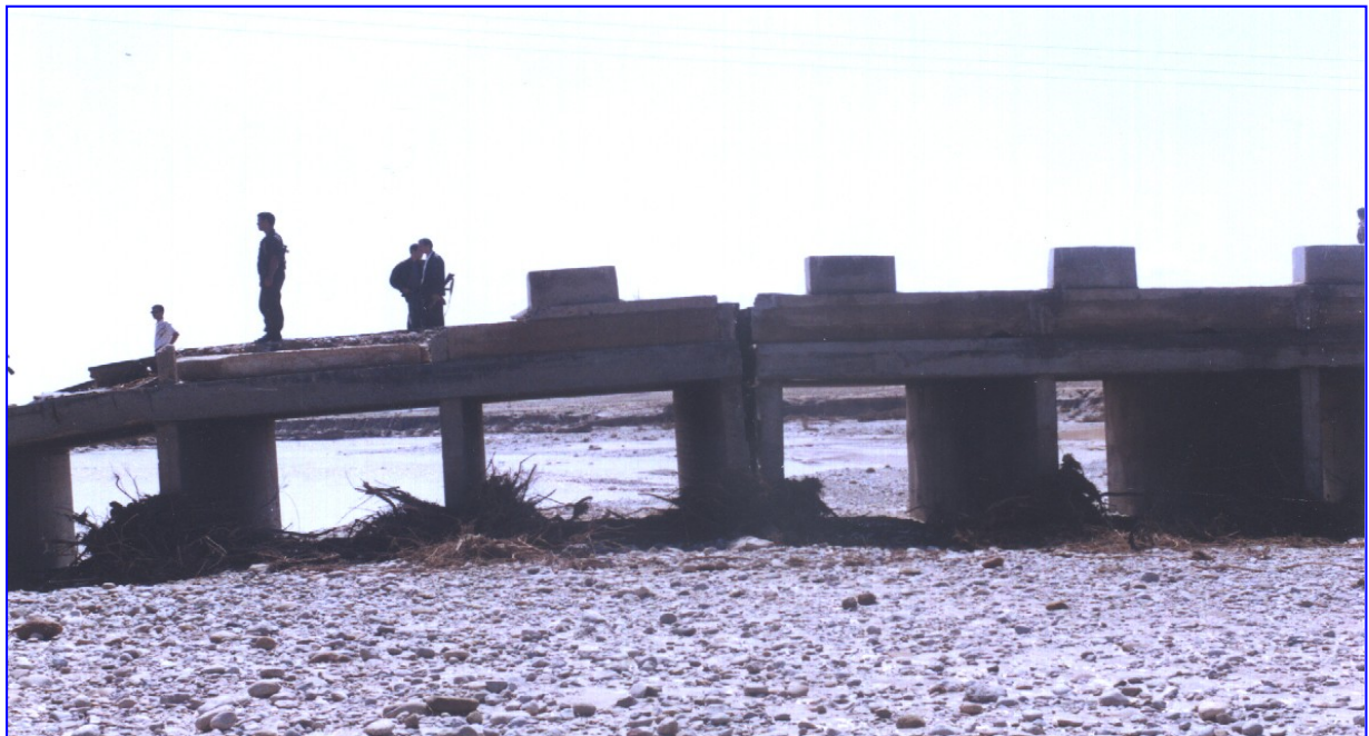
Photo 1: ABSENCE de dispositifs de protection à l'aval du radier.
