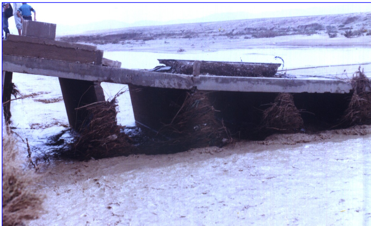
Photo 3: L'ouvrage ruiné après le passage de la crue
