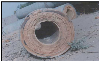
Tartre d'argile dans une conduite (Messaitfa, 2004)
